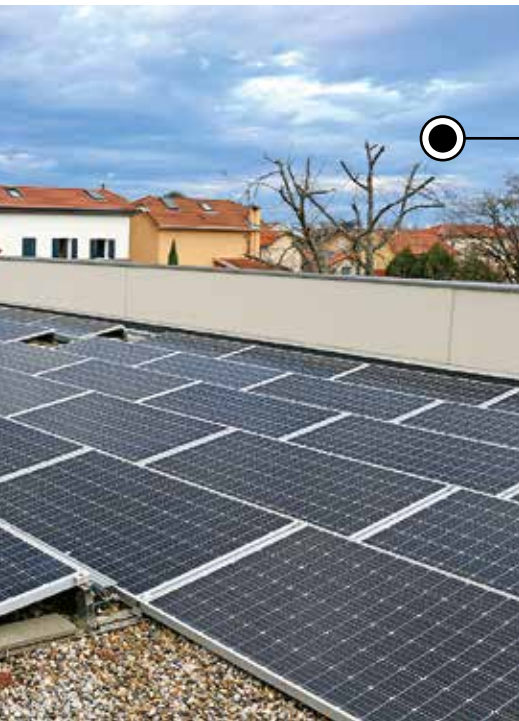
74 modules solaires photovoltaïques sont installés sur le toit du groupe scolaire Pierre Moutin.
